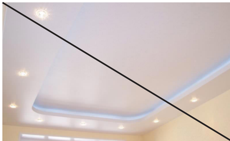
Плохо Многоуровневые гипсокартонные конструкции
