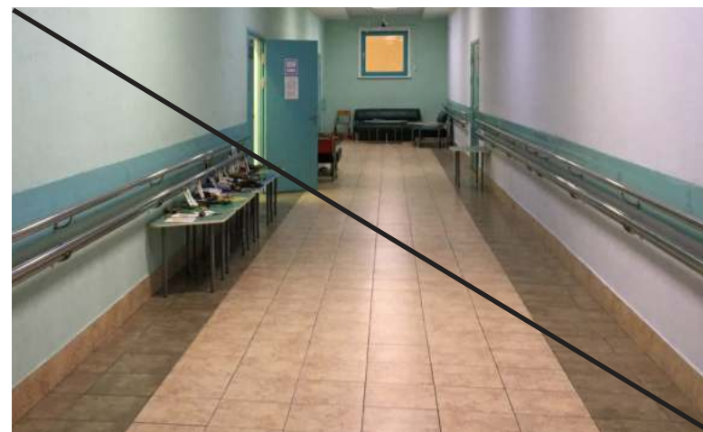
Плохо Керамогранитная плитка мелкого формата (менее 500×500 мм) с крупными швами
